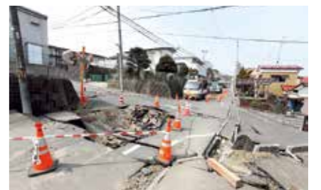
仙台市内では道路の陥没が相次いだ
