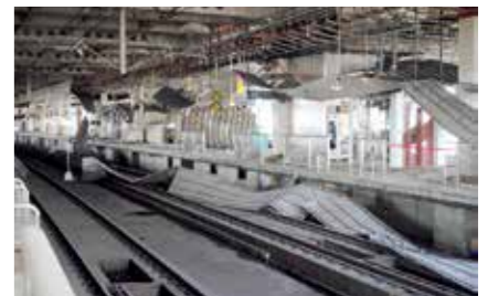
仙台駅新幹線ホームでは天井が抜け落ちた
