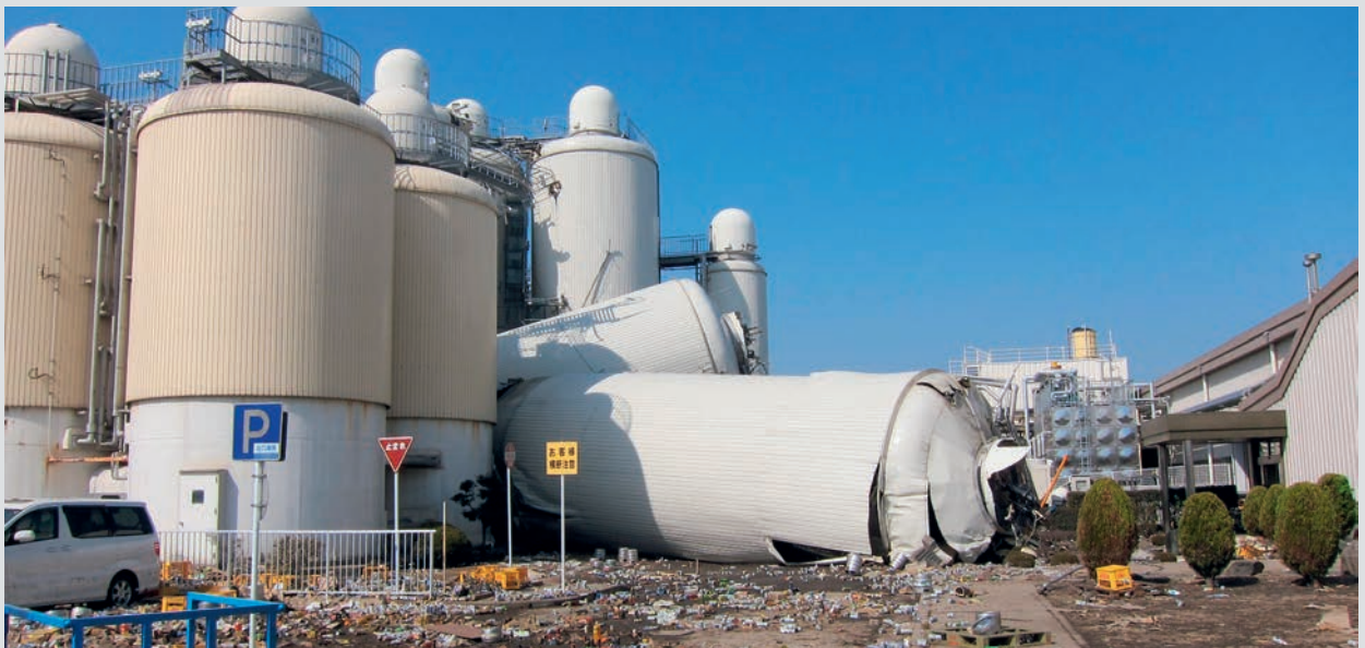
キリンビール仙台工場では15本あるタンクのうち4本が倒壊した。(仙台市宮城野区)
