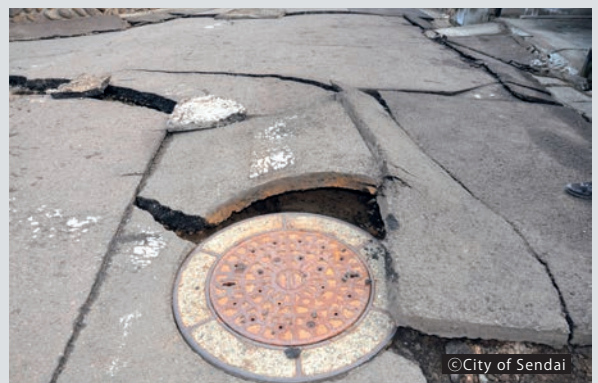
内陸部にある団地内の道路ではアスファルトが損壊した。 (仙台市青葉区) 写真提供: 仙台市
