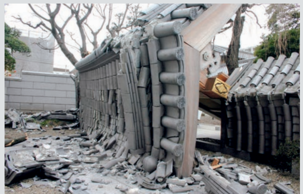
壁と門扉が崩壊し、瓦が散乱した仙台市中心部の寺院。 (仙台市宮城野区)
