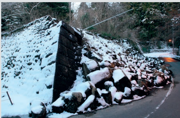
城下町仙台のシンボルである仙台城の石垣も数カ所で崩壊した。 (仙台市青葉区)
