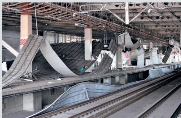
JR仙台駅の東北新幹線ホームでは天井板が落下。 壁も崩壊し、漏水も生じた。(仙台市青葉区)
